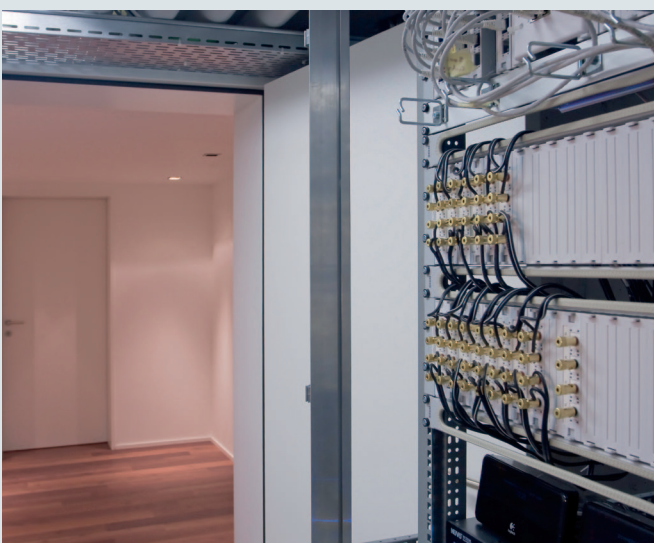
Der Verteilschrank: Durch die übersichtliche, flexible Verkabelungsstruktur können Mutationen und allfällige Update's ohne grossen Aufwand realisiert werden.
